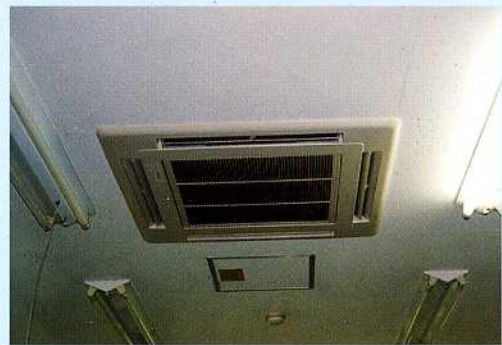
●空調設備の点検整備
