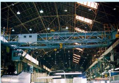
●クレーンの法定検査
