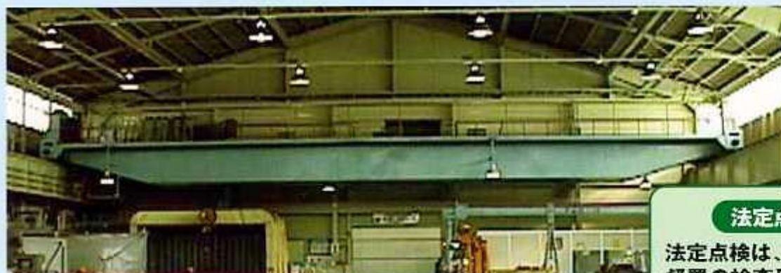
●天井走行クレーン
